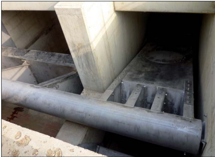
Bild 2: Wehranlage mit Anordnung Schwimmkörper rechts
